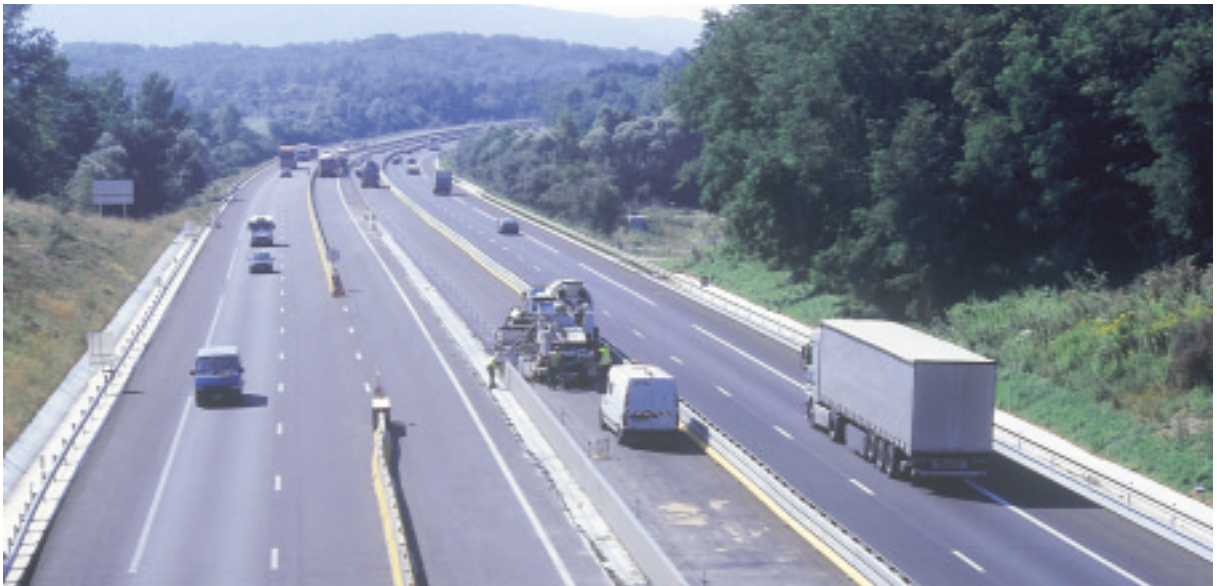
Autoroute A40 : réalisation de glissières de sécurité en béton armé, pérennes et faciles à entretenir.
