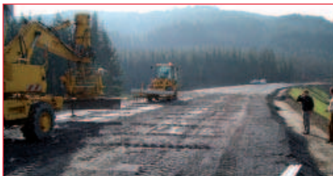
L'atelier de mise en œuvre des Joints Actifs®, procédé de fissuration des assises, mis au point par SACER.
