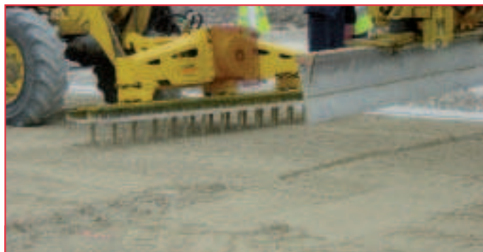
Création, par vibro-fonçage et avant compactage, d'un sillon transversal dans la couche de matériau traité.
