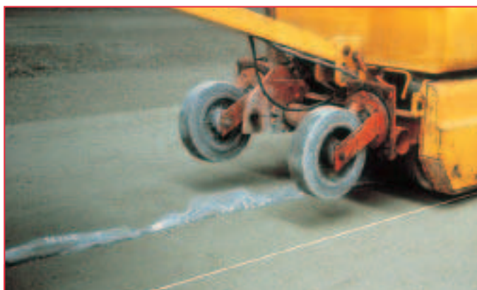
Machine à trancher les joints en position de travail. L'incorporation, dans le joint, d'une feuille de polyane permet d'éviter les épaufrures aux bords de l'entaille.
