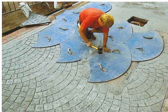
▲ La fermeté du béton impose de marteler suffisamment les moules afin d'imprimer correctement le motif.
