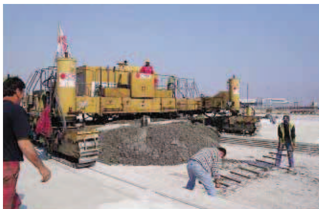
▲ Des goujons montés sur des paniers métalliques sont positionnés à l'aplomb du futur joint de dalle. Ce dispositif transfère les charges d'une dalle à l'autre sans entraver les mouvements de dilatation.
