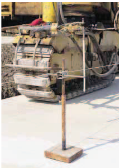
▲ Quand elle progresse en clavage, la machine prend comme référence la hauteur des bandes existantes situées de part et d'autre. Le guidage en direction est donné par un fil.
