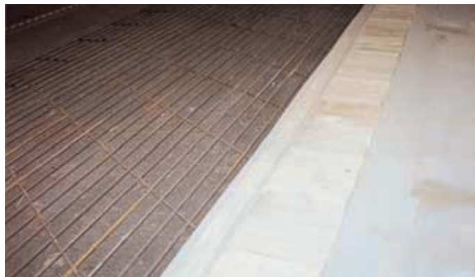
Le béton armé continu (BAC) garantit la régularité de l'uni et l'absence de joints.
