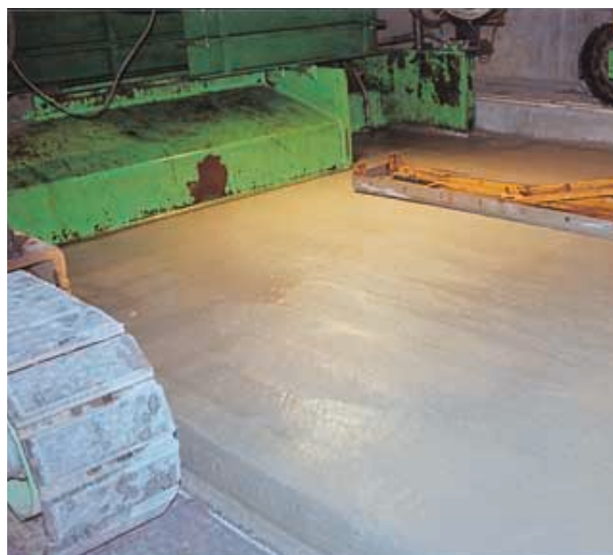
La pérennité des caractéristiques structurales et de surface du béton limite la consommation en carburant.
