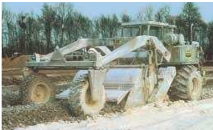
La technique du traitement à la chaux et au ciment est de plus en plus utilisée pour les terrassements, mais aussi pour la réalisation des chaussées elle-mêmes.
