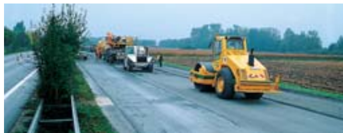
Le passage des compacteurs termine la mise en œuvre des matériaux recyclés en place.
