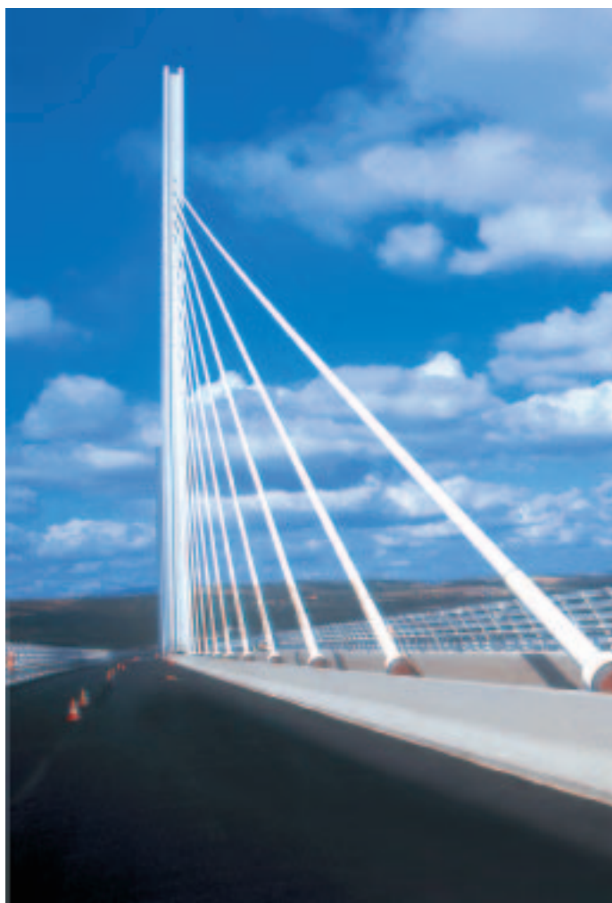
Le terre-plein central du viaduc de Millau (Aveyron) est équipé de glissières anti-franchissement en béton extrudé.
