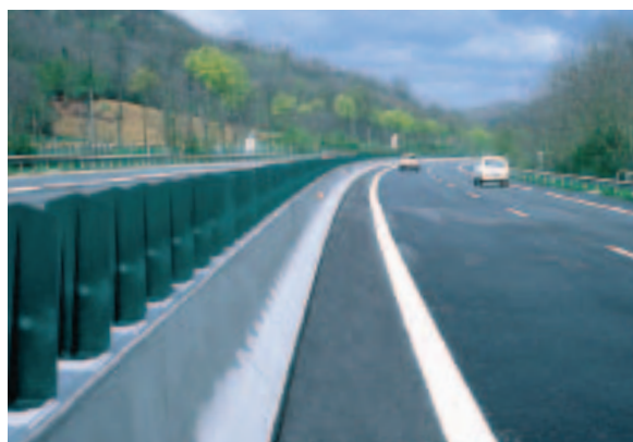
Sur cette voie, une protection anti-éblouissement est associée à la glissière en béton.
