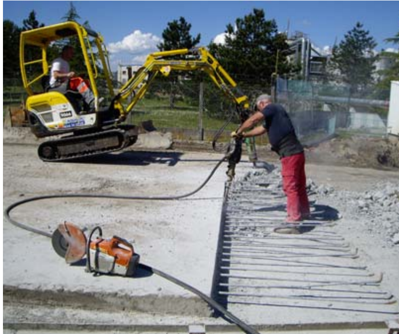
Photo 16 : Dégagement d'armatures de béton armé continu (Crédit photo : CMR Exedra)
