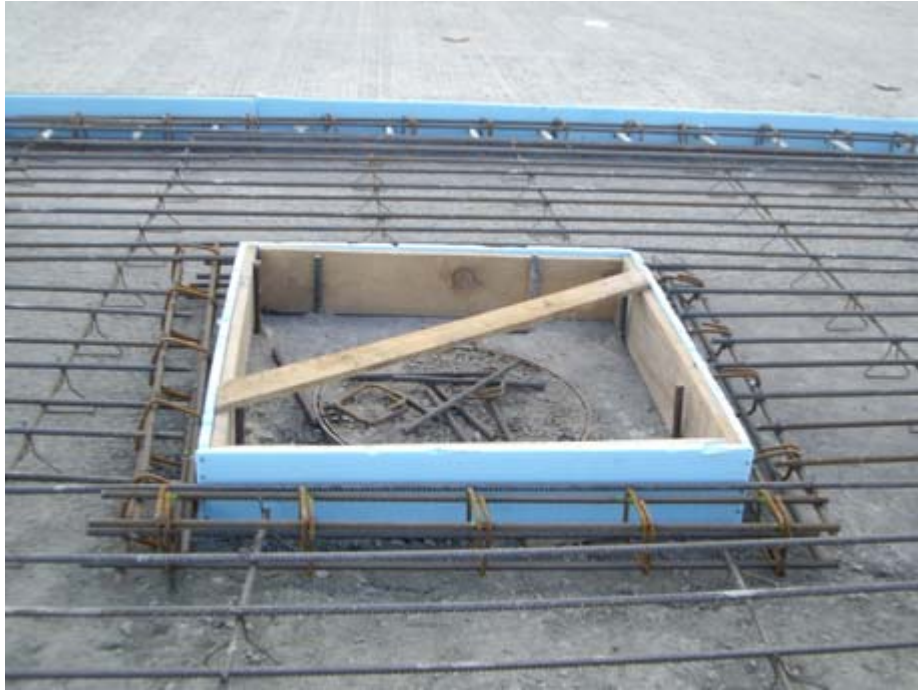
Photo 11 : Réserveur autour d'un regard de visite (Crédit photo : CMR Exedra)
