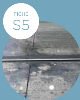
ENCRASSEMENT DE SURFACE
