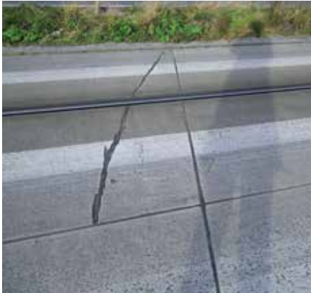
F5 Fissure oblique en pleine dalle
