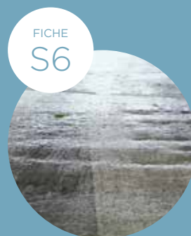
DÉFAUT D'UNI LONGITUDINAL
