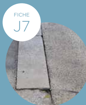
DÉFAUT D'INTERFACE ENTRE LE BÉTON ET UNE VOIRIE OU UN CANIVEAU
