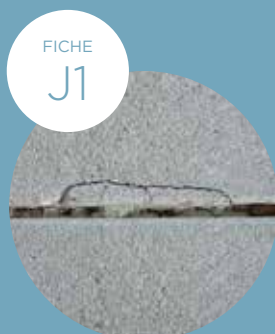
EPAUFRE OU CASSURE EN BORD DE JOINT DE DALLE
