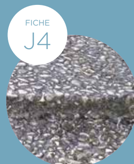
DÉCALAGE DE DALLES AMONT ET AVAL
