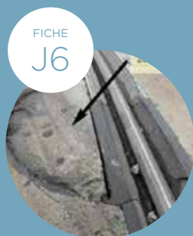
DÉSORDRE ENTRE LE JOINT DU RAIL CENTRAL DU TCSP ET LE BÉTON DE LA PLATE-FORME
