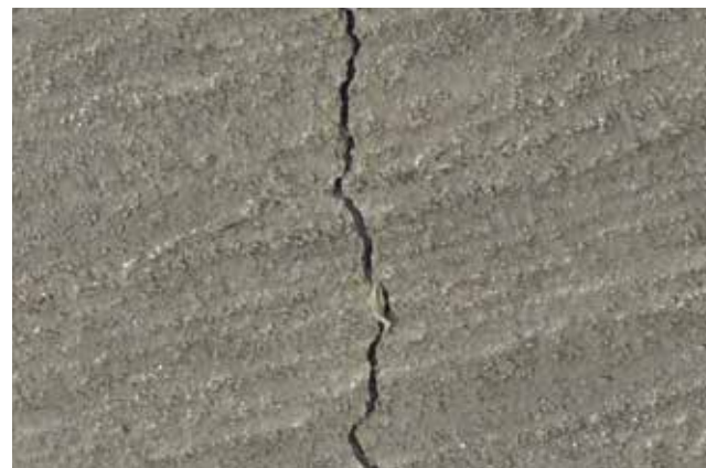
Fissure de retrait non maîtrisé ©CIMbéton
