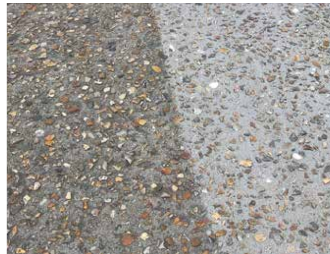
Passage piéton rénové par granailage : à gauche avant traitement, à droite après traitement ©CIMbéton
