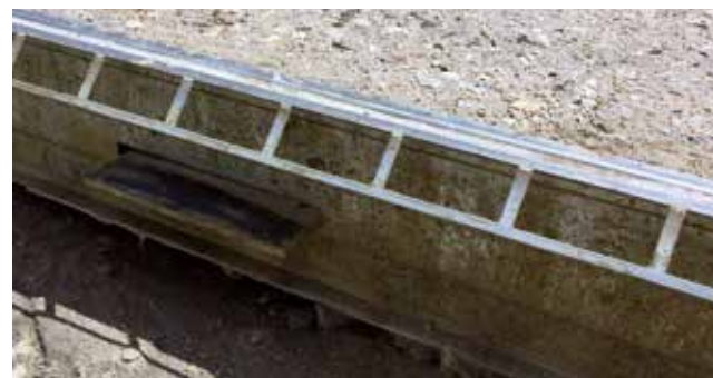
Joint de dilatation - Chantier de l'hôtel de ville de Vire Normandie ©RCR déco France
