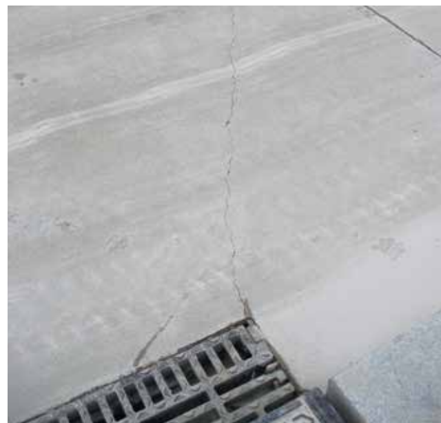
Fissuration provoquée par une émergence (en l'absence de disposition constructive adaptée), causée par la réduction de la section transversal de la dalle ©Agilis
